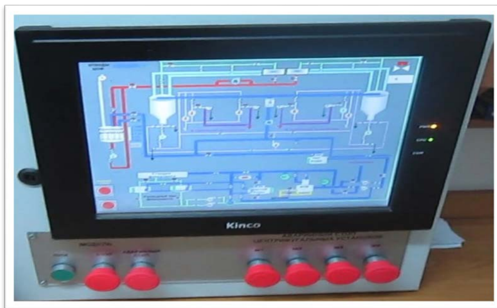
Рис. 2. Пульт управления Модулем очистки
