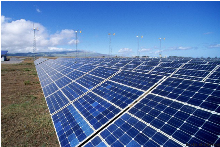
Мал.11. Сонячна електростанція та вітрогенератори
