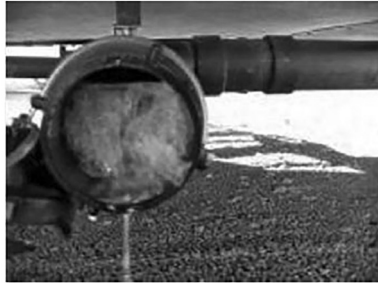
Рис. 16. «Пробка» із льоду в трубі
